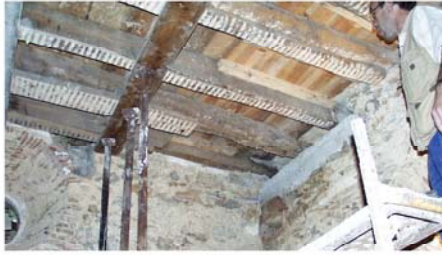
Reparação de secções degradadas de vigas de madeira de um pavimento utilizando produtos poliméricos e FRP.
