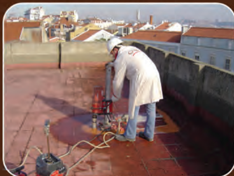
Extracção de carote na laje de cobertura de um edifício, para caracterização do material
