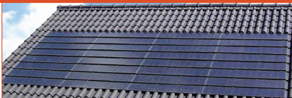
Telhado fotovoltaico SOLESIA.
