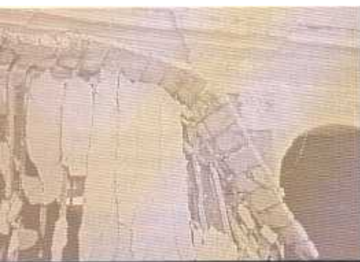
Fig. 1 – Catedral de Noto, Itália, acidente de 196: a substituição de um piso de madeira por uma laje de betão, contribuiu para agravar os efeitos do acidente provocado pela cedência de uma coluna de alvenaria [Crocchi, 1998]
