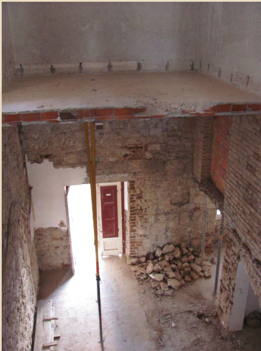
Reabilitação muito intrusiva
