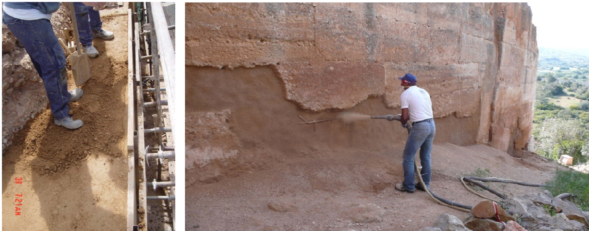
Figura 6. Reabilitação duma construção em taipa: À esquerda, pelo processo tradicional, modificado. À direita, utilizando a técnica "Terra projetada", desenvolvida no Grupo Stap.
