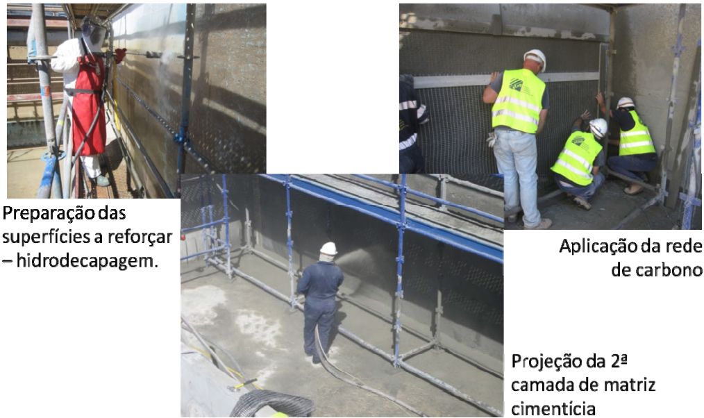
Figura 4. Sistema de reforço estrutural de compósito de fibras de carbono com matriz cimentícia Armo Mesh, da S&P, aplicado na reabilitação duma estação de tratamento de águas (Fotos Stap).
