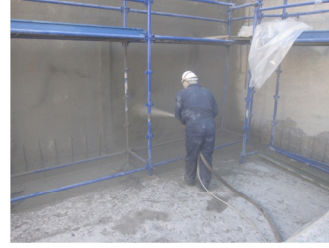
Projeção da 1ª camada de matriz cimentícia aplicada por via seca com máquina de câmara dupla “sprayed concrete”
